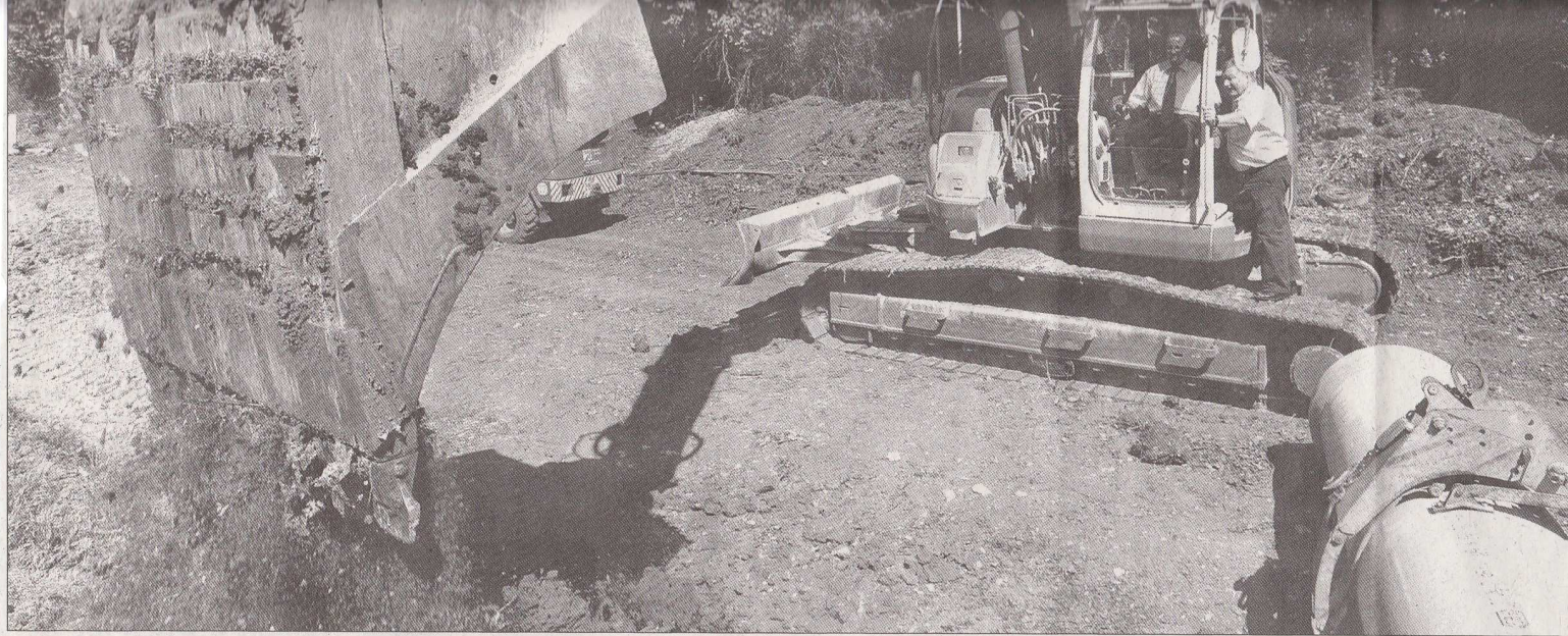
Bürgermeister Andreas Hölzlberger, hier mit Ortsvorsteher Günther Graef, durfte gestern in Unterschwandorf mit dem Bagger graben. Foto: Katzmaier
